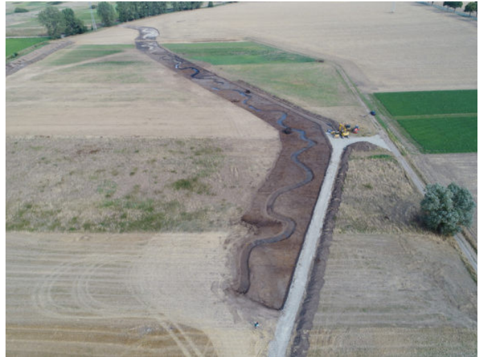
Abb. 4: In einem ersten Schritt erfolgte GPS-gestützt der Bau von Sekundäraue und Initialgerinne. Die anfallenden Bodenmassen wurden zur Wiederverfüllung des alten, begradigten Profils, zur Verbesserung zuvor ausgewählter landwirtschaftlicher Nutzflächen und zur Rekultivierung zurückgebauter Wege innerhalb des Flurbereinigungsgebietes genutzt. (Foto: Wolfgang Figura)
