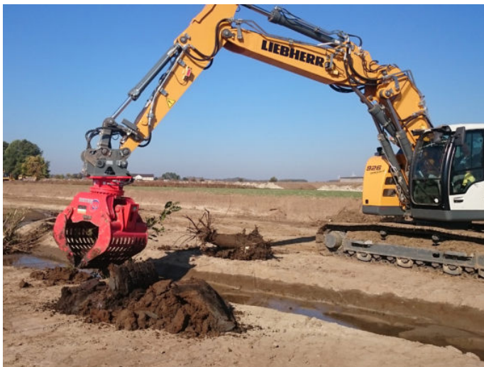
Abb. 5: In einem zweiten Schritt wurde das Initialgerinne wie auch die Sohle der Sekundäraue rau gestaltet. Dazu diente der Einbau von gesicherten Totholzelementen, der Einbau von Feinkies-Depots, punktuelle Profilaufweitungen und Profilverengungen sowie die Anlage von Blänken. (Foto: Klaus Leifels)
