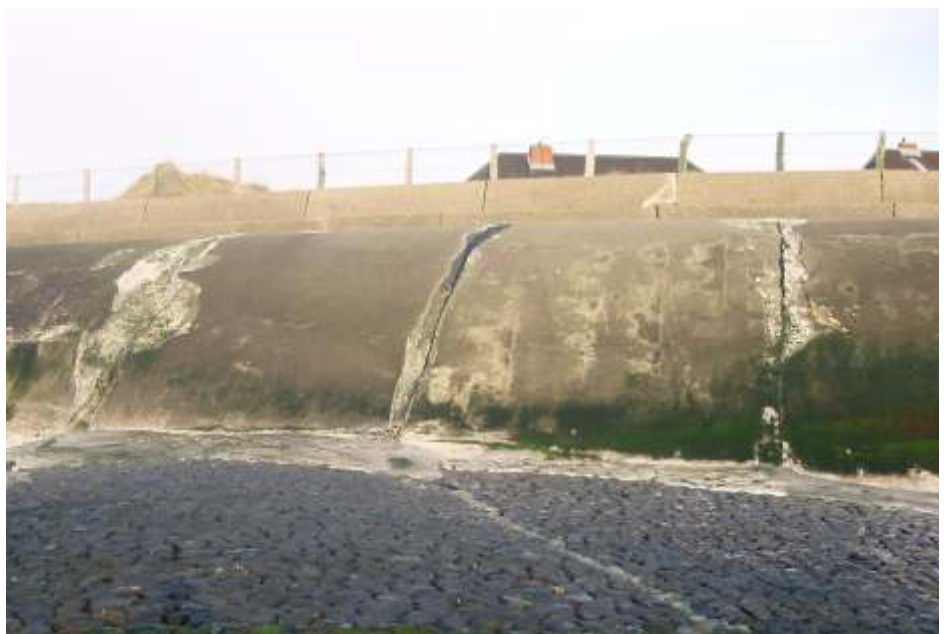
Abb. 5: Schäden am S-Profil Anfang 2008
