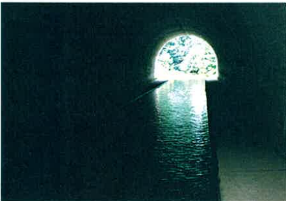
Foto 83: Durchlass / Ufer unterbrochen
