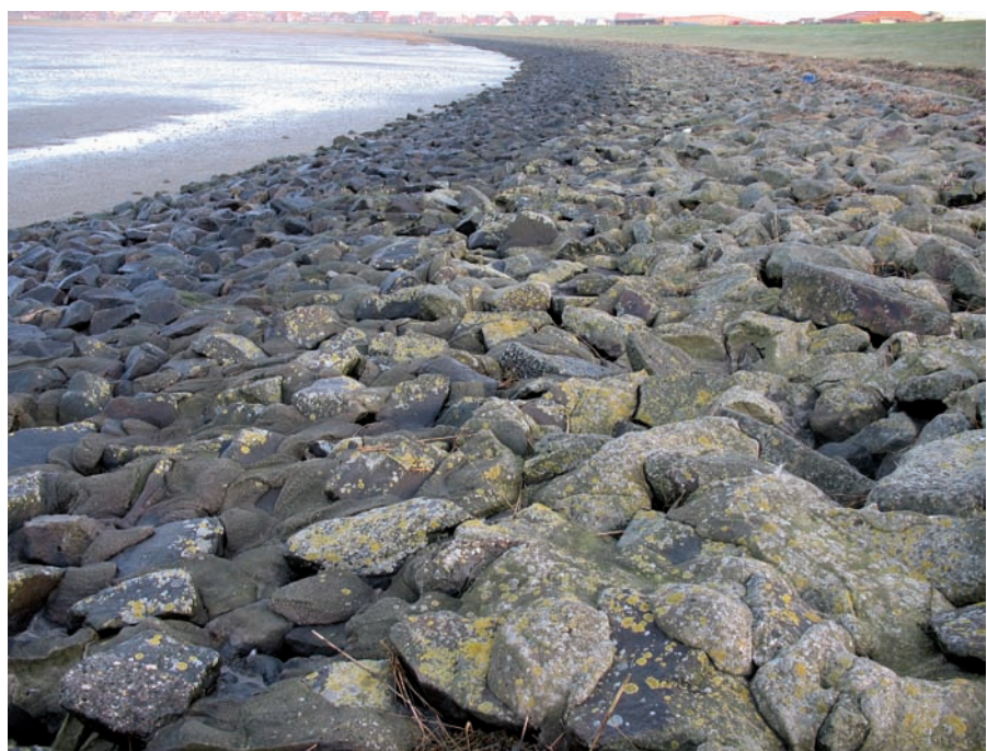
Abb. 21: Steinschüttungen im Gezeitenbereich weisen eine sehr deutliche Zonierung der Flechtenbesiedlung auf. Foto: U. de Bruyn
