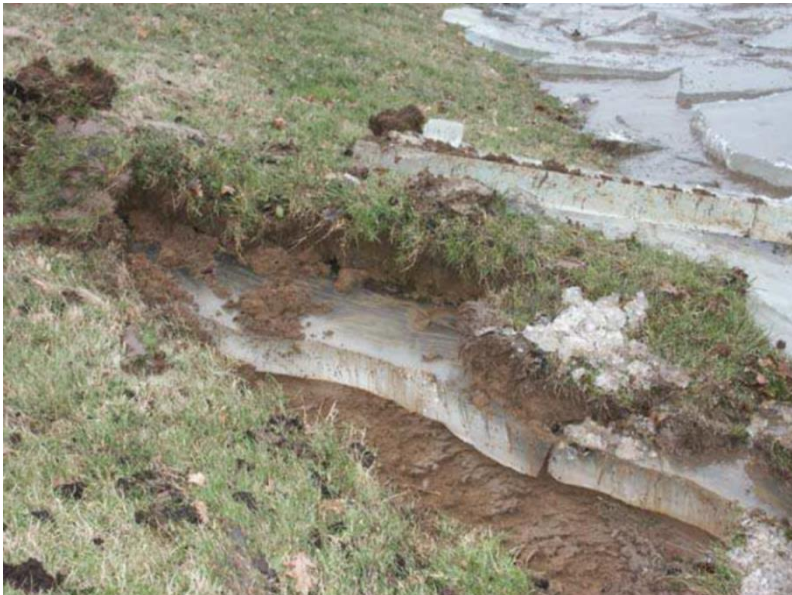
Foto 4.1 Schaden am Deich im Artlenburger Deichverband durch das Eishochwasser von 2003 (Quelle: Thiemann)
