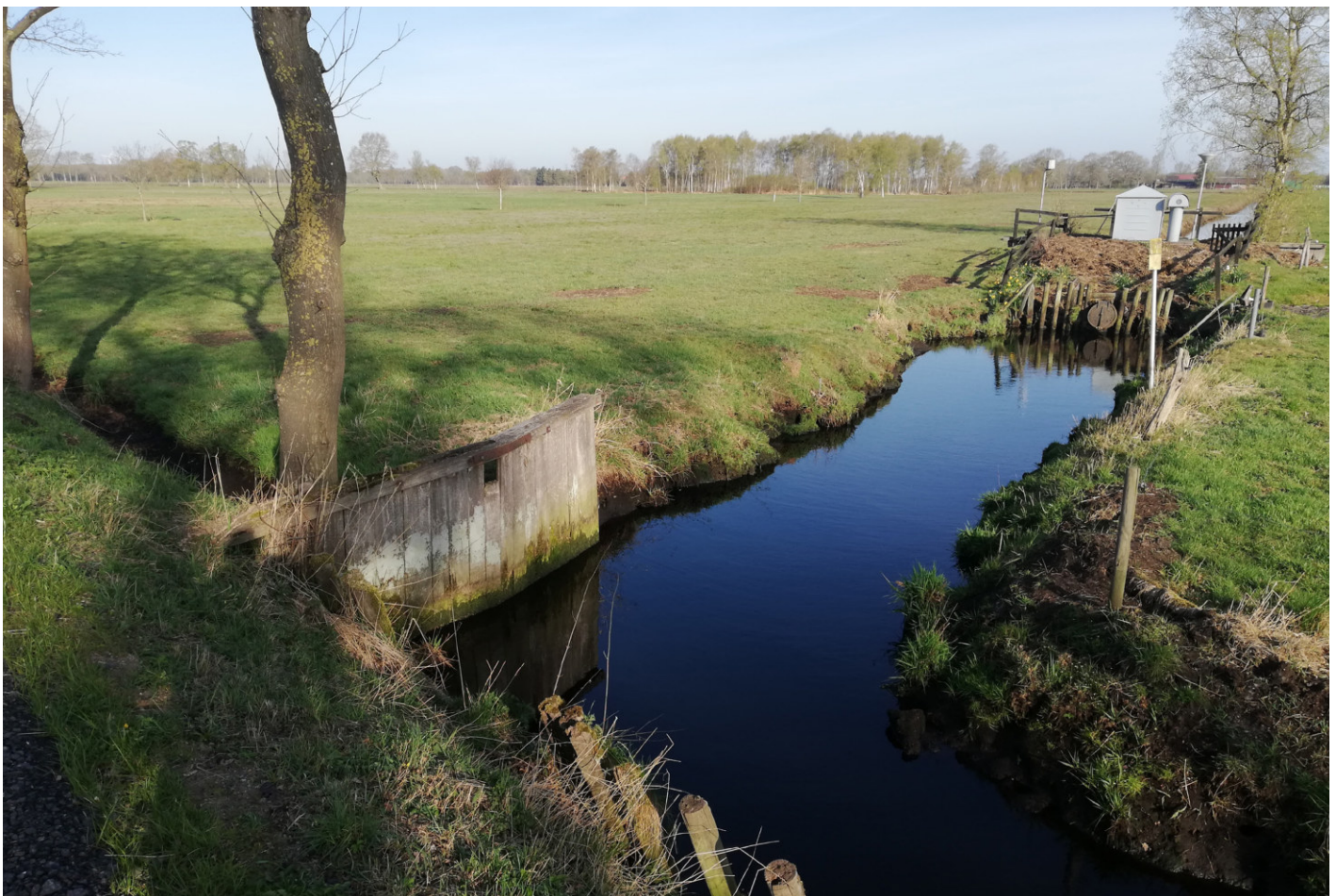
Abb. 4: Typische Situation in der Moormarsch: Graben, Unterschöpfwerk und landwirtschaftliche Nutzung (Grünland dominiert) in der Wesermarsch. Am ehemaligen Staubrett mit Überlauf-Durchlass sowie an der aus der Geländeoberfläche herausragenden Pumpenanlage sind die Folgen von Landsackung bzw. Torfzersetzung zu erahnen. (Foto: Oliver-David Finch)
