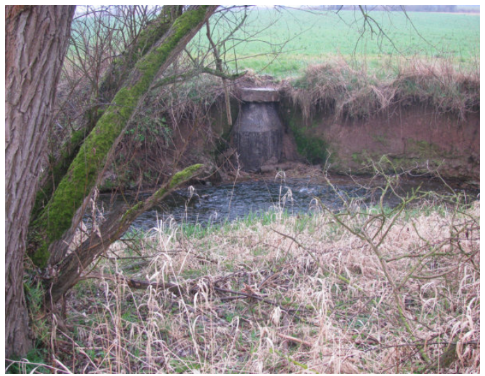
Abb. 23: Uferschädigungen durch unnatürliche Breitenerosion (Foto: Jochen Lampert)
