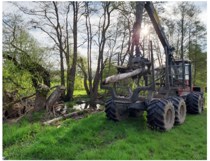
Abb. 25: Zur erforderlichen Beseitigung einer örtlichen Verklausung kann im Bedarfsfall beispielsweise auch der Forwarder zum Einsatz kommen. (Foto: Jochen Lampert)
