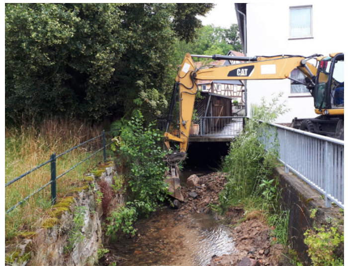
Abb. 22: Teilräumung einer Ablagerung vor einem Brückendurchlass (Foto: Jochen Lampert)
