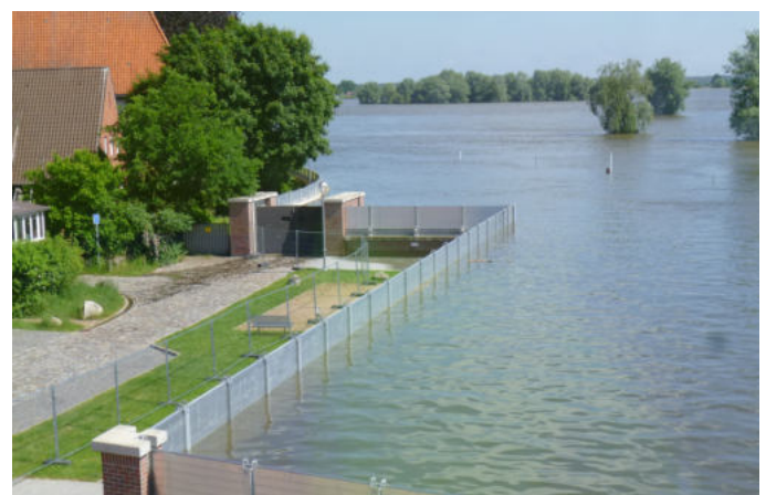
Abbildung 16: Teilmobile Hochwasserschutzwand in Hitzacker
