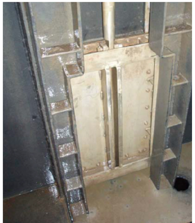
Abb. 4: Fischklappenanlage (Schütz im Hubtor) im Siel und Schöpfwerk Sautel (aus Finch 2010).
