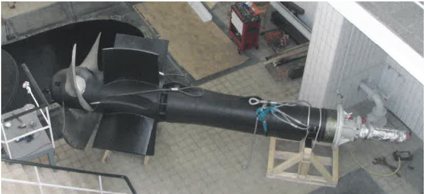
Abb. 12: Propellerkopf mit Welle einer Pumpe des Siel und Schöpfwerks Knock (hier zu Wartungszwecken ausgebaut; aus: EV Emden o.J.).
