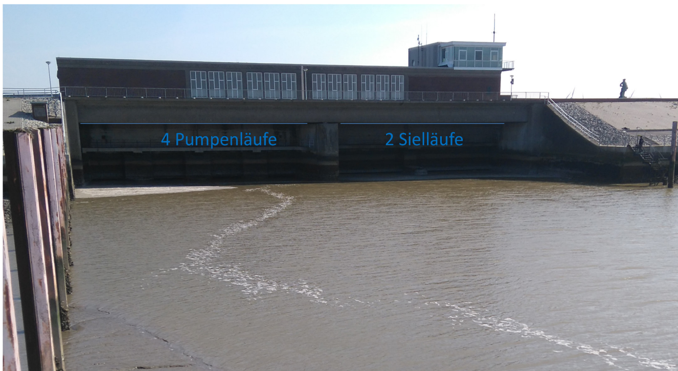
Abb. 2: Siel und Schöpfwerk Knock, emsseitige Ansicht, mit den nördlich gelegen vier Pumpen- und den südlich gelegen zwei Sielläufen (Foto: Finch).
