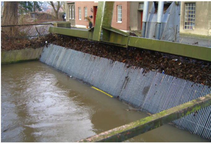
Abb. 8: Rechenanlage im Zulauf einer Wasserkraftanlage (Foto: LAVES)
