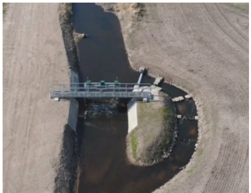
Abbildung 13: Stauanlage mit Fischpass in der Tanger (Sachsen-Anhalt) zur Regulierung der Wasserstände (Quelle: mdr)
