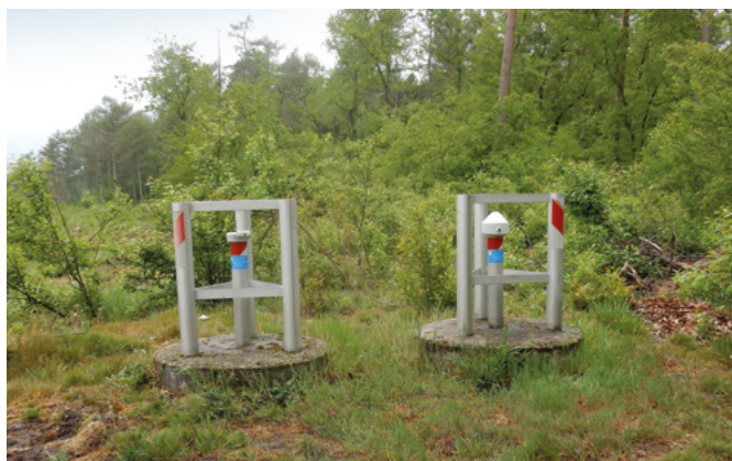
Überflur ausgebaute Grundwassermessstellen Elbergen-Moor I und II (Landkreis Emsland).
