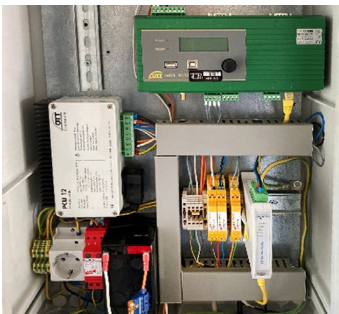
Blick auf die Technik in einem Pegelkasten.
