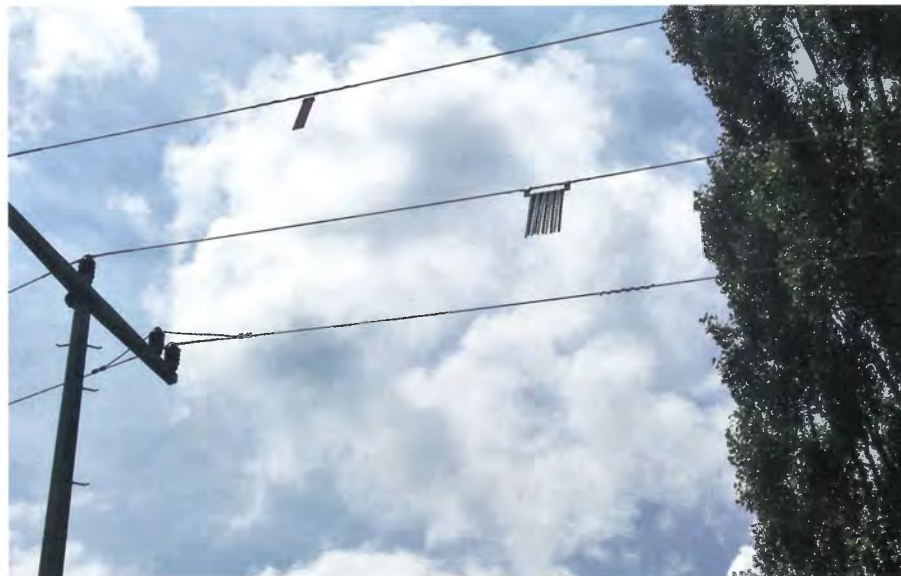
Abb. 14: Schwarz-weiß-Markierung an einer Demonstrationsleitung vor einem hellen Hintergrund (Himmel). Die schwarzen Stäbe treten hervor.
