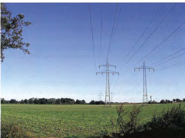
Abb. 4: Vorhandene 110-kV-Freileitung und 110-kV-Bahnstromleitung südlich Dreeke. Foto: Bernd Blanke
