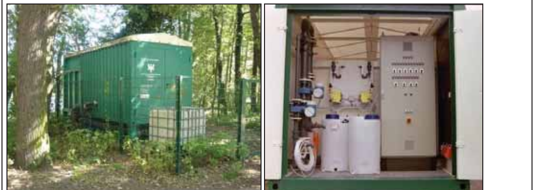
Pelicon®-Anlage: Container von außen und innen [Bildquelle: Herr Damann, Enviplan]
