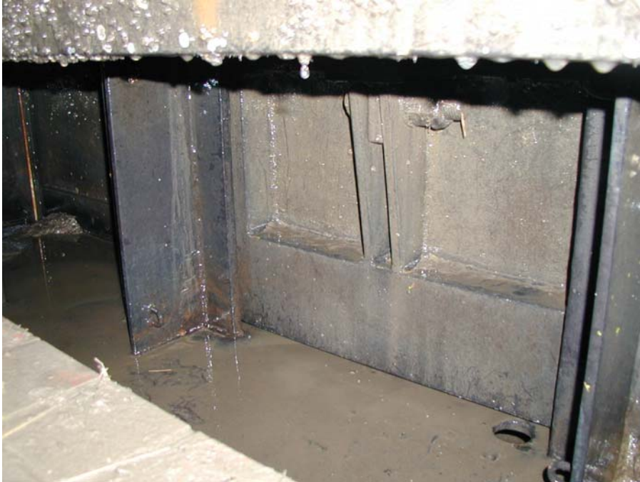
Abb. 24: Öffnungsschütze im Hubtor eines Siellaufes Petkumer Siel
